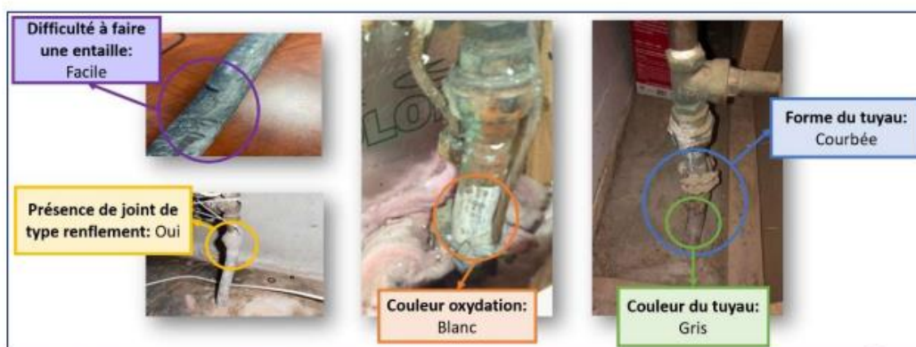
Figure 4 - Caractérisation de la nature du branchement de service
